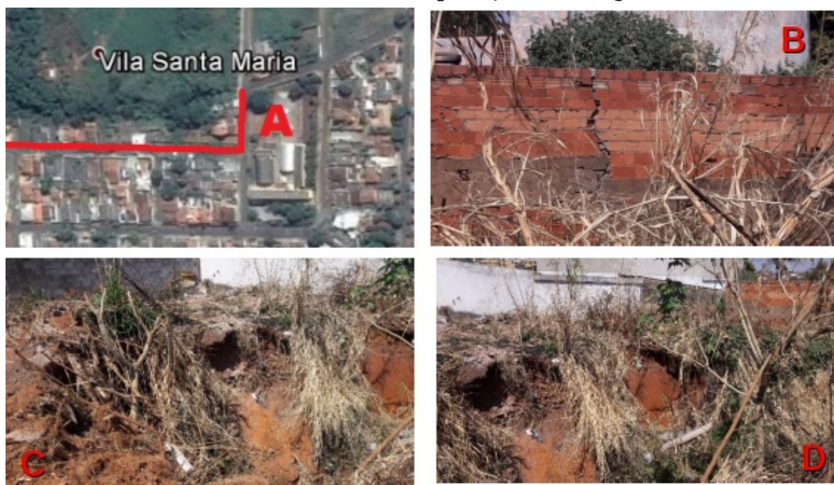
Figura 4 – Ponto A do trecho do Córrego Catingueiro, processos erosivos em B e D e fissuras em muro construído na área de proteção do córrego em C.
