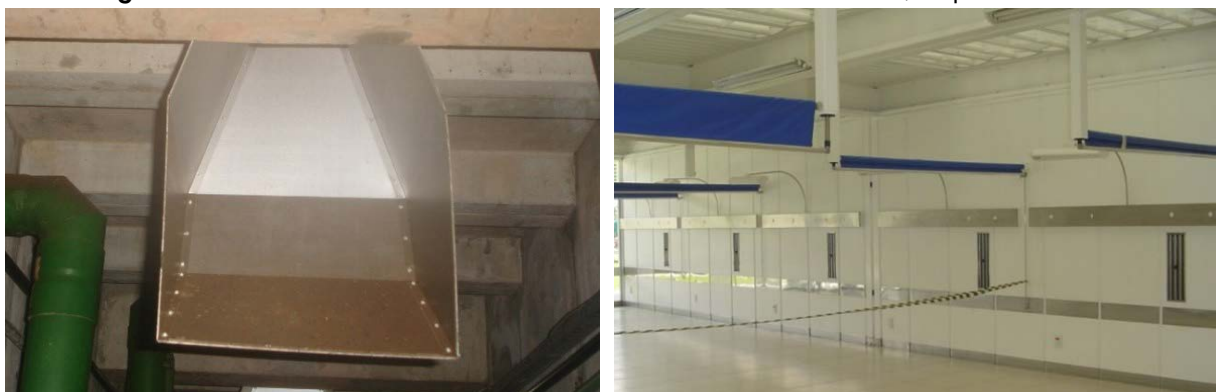
Figura 16 - dutos de ar no Sarah-Rio e venezianas nas enfermarias, respectivamente.
