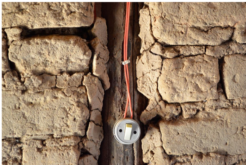
Figura 2.3- A fiação elétrica exposta documenta a simplicidade da habitação e adaptabilidade do construtor que evitou intervenções na parede já pronta. Fonte: Acervo do autor, 2014.
