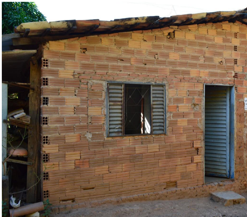
Figura 3- O construtor dessa habitação, localizada no Distrito-Sede, utilizou materiais construtivos contemporâneos e tradicionais: tijolos vazados, tijolos maciços e blocos de adobe.
