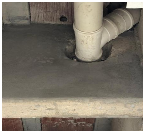
FIGURA 1: Descontinuidade não prevista em viga.
