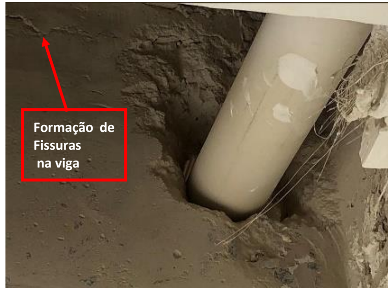
FIGURA 3: Viga com furo não previstos em região crítica FONTE: Próprios Autores (2023)
