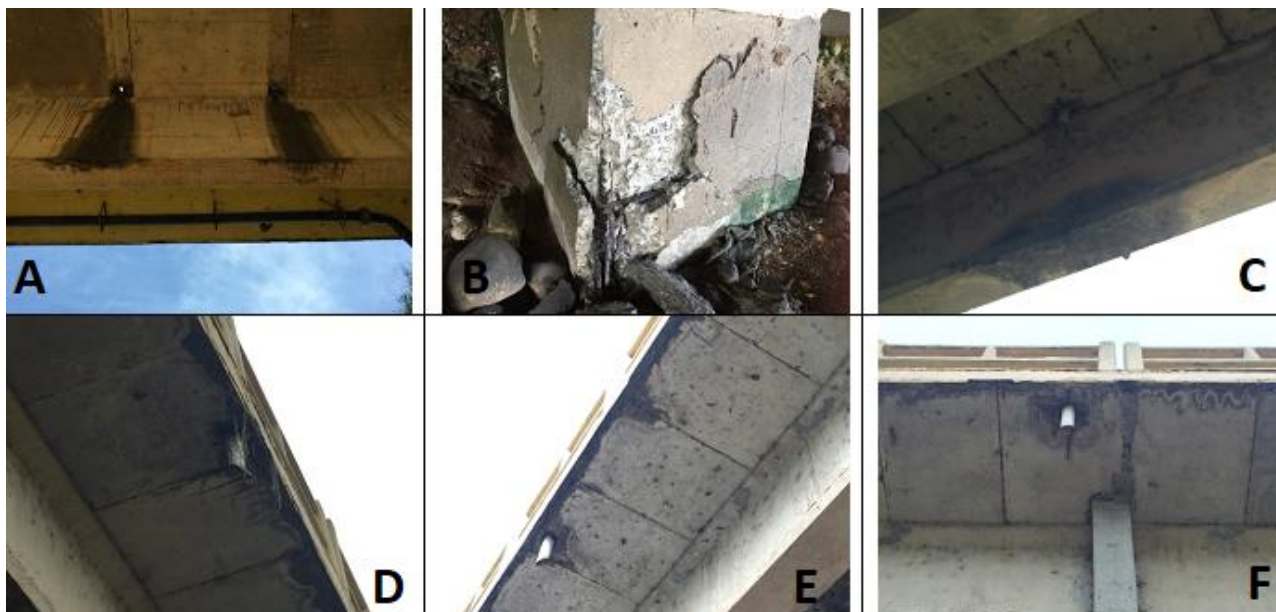
FIGURA 2: Principais manifestações patológicas identificadas: A = manchas de infiltração na ponte 1; B = desagregação do concreto e corrosão das armaduras na ponte 1; C = manchas de infiltração nas pingadeiras das vigas longarinas da ponte 4; D e E = manchas de infiltração, desagregação do concreto e corrosão das armaduras da laje de passeio da ponte 4; F = manchas de infiltração, desagregação do concreto e corrosão das armaduras nas pingadeiras. Fonte: Elaboração própria.
