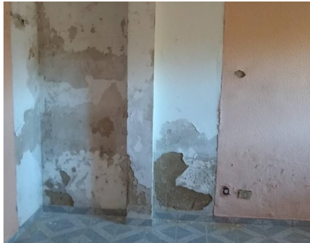
FIGURA 1: Efeito da umidade do solo na alvenaria de uma sala FONTE: Autoria própria (2020).
