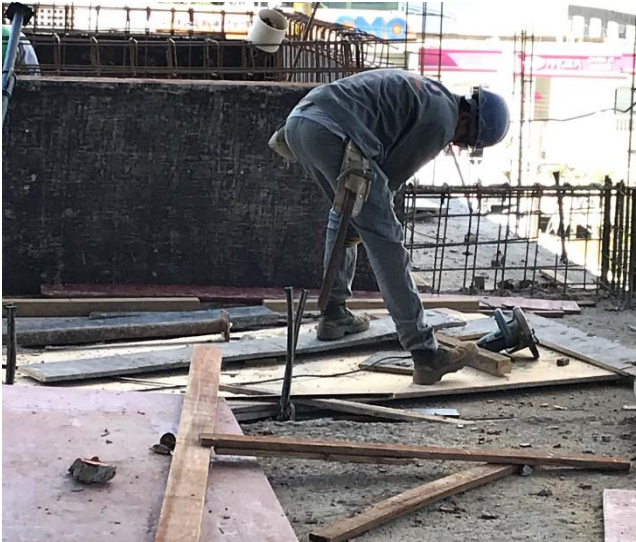
FIGURA 14: Ausência de bancada de apoio para execução do serviço na obra C.
