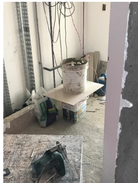
FIGURA 13: Bancada de apoio indevida para execução do serviço na obra B. FONTE: Autoria própria/Obra B.
