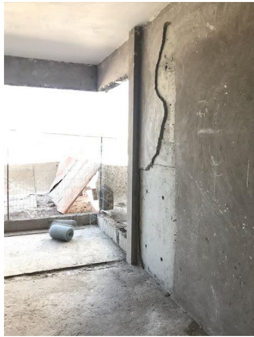
FIGURA 12: Deslocamento do reboco interno na obra B. FONTE: Autoria própria/Obra C.
