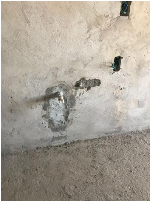
FIGURA 10: Retrabalho nos pontos de água. FONTE: Autoria própria/Obra B.
