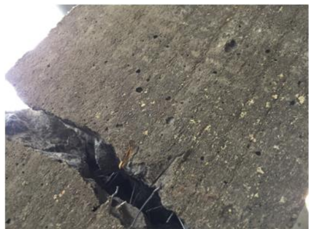
FIGURA 10: Detalhe da fissura Viga 5.
