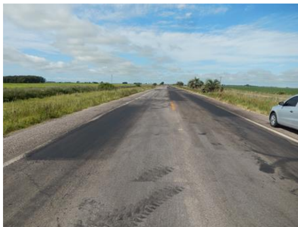
FIGURA 9: Resultado da primeira solução empregada para a recomposição da camada asfáltica danificada.
