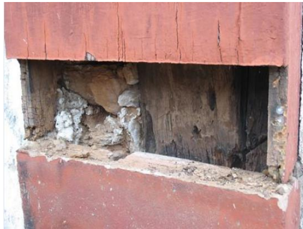
FIGURA 8: Esteio deteriorado por ação da umidade e dos insetos xilófagos.
