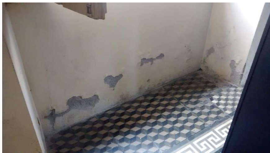
FIGURA 5: Descolamento com empolamento, levantamento de dezembro/2015.
