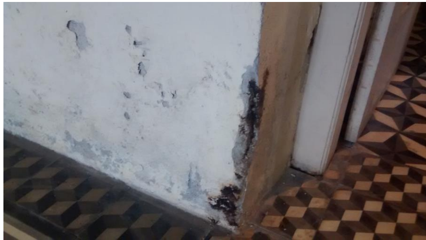
FIGURA 4: Descolamento e bolor em parede interna.
