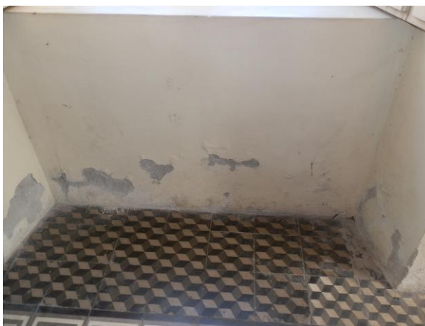
FIGURA 6: Descolamento com empolamento, levantamento de março/2016.
