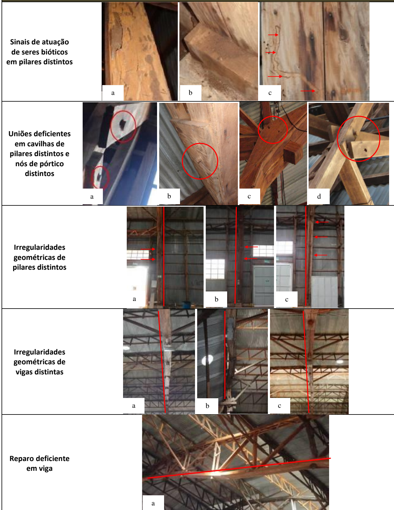
QUADRO 2: Registro de algumas das manifestações patológicas identificadas no IBC (Continuação).
