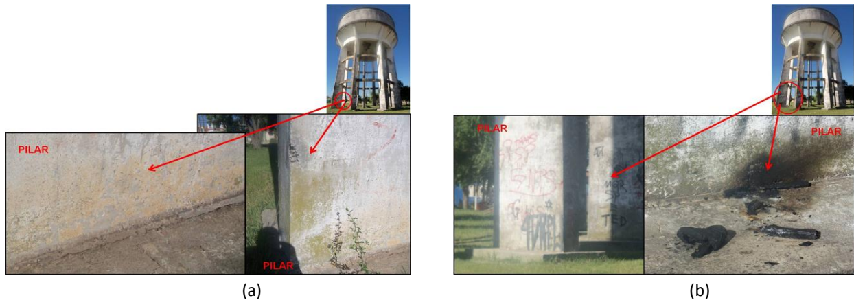
FIGURA 4: R10 T - Manifestações patológicas nos pilares: (a) fissuração; (b) ação de vandalismo.
