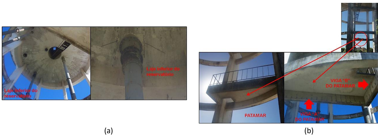
FIGURA 5: R10 T - Manifestações patológicas nas lajes: (a) laje inferior; (b) patamar.
