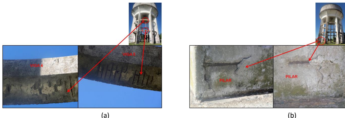
FIGURA 3: R10 T - Manifestações patológicas: (a) nas vigas 4 e 5; (b) nos pilares. FONTE: AUTORA – 2014.
