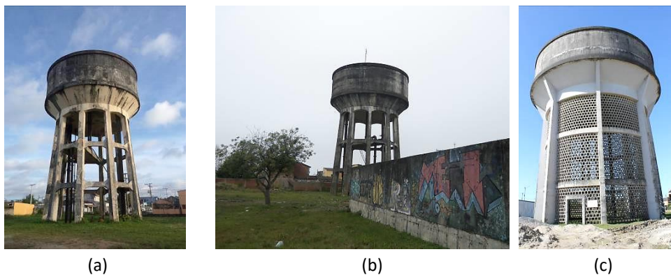
FIGURA 2: Reservatórios: (a) R5 T; (b) R7 T; (c) R8 T. FONTE: AUTORA – 2014.
