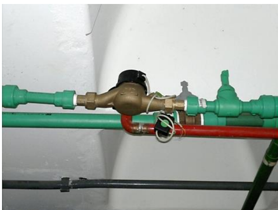
FIGURA 4: Hidrômetro instalado no Estabelecimento 4.
