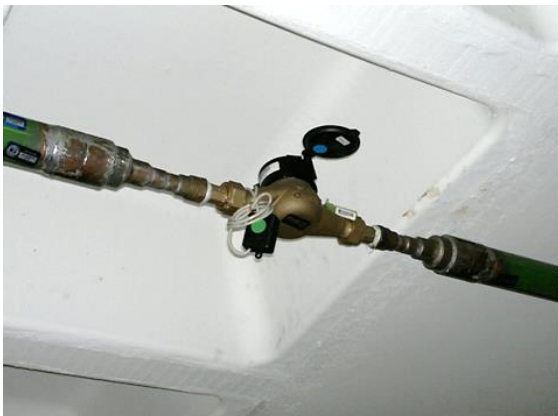
FIGURA 3: Hidrômetro instalado no Estabelecimento 1.
