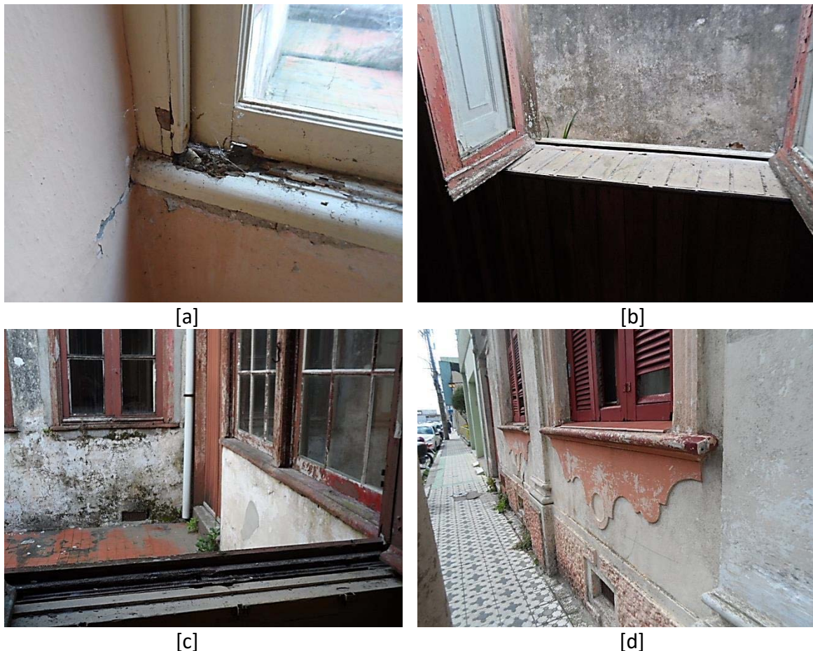
FIGURA 14: Deterioração das esquadrias: (a) vista interna da madeira de esquadria em processo avançado de degradação; (b) vista externa da madeira de esquadria em processo avançado de degradação; (c) vista geral das esquadrias em avançado processo de deterioração; (d) outra vista geral das esquadrias em avançado processo de deterioração.
