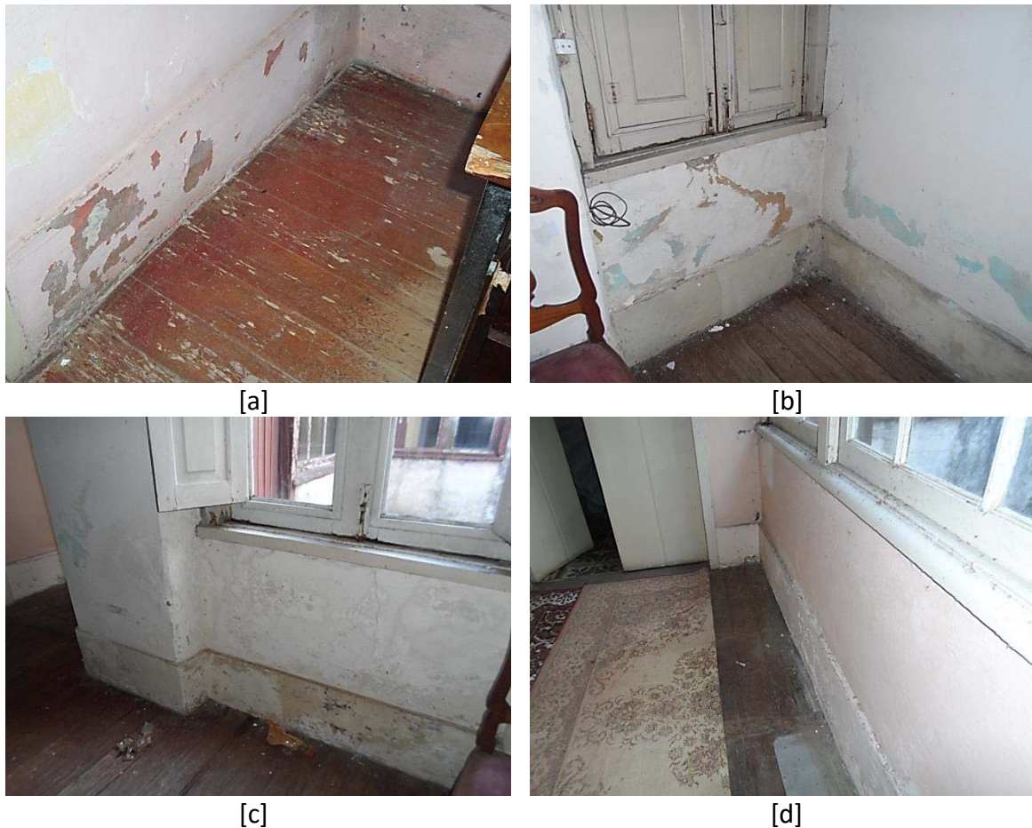
FIGURA 16: Umidade ascendente: (a) umidade próximo ao piso; (b) processo de umidade por capilaridade abaixo da janela; (c) outra esquadria da casa com umidade ascendente; (d) parede e piso da residência com umidade ascendente.
