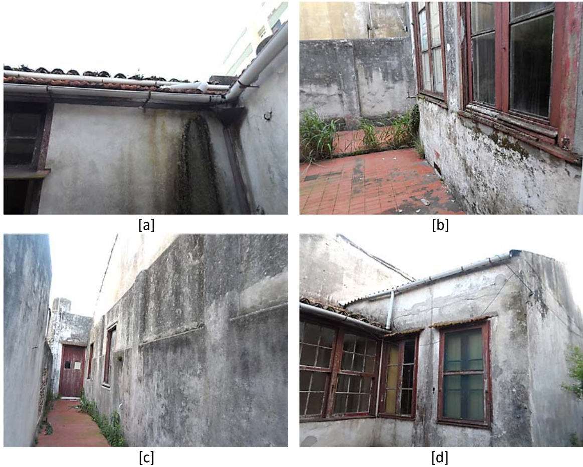
FIGURA 12 – Sujidades e deterioração das pinturas externas: (a) sujidade com origem de colapso da calha; (b) sujidade abaixo das janelas; (c) sujidade nos muros de acesso lateral da casa, local sem incidência solar; (d) sujidade ao redor das esquadrias. Fonte: arquivos pessoais das autoras.
