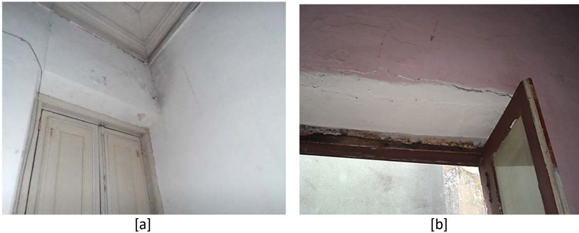
FIGURA 10: Fissuras nos cantos das janelas: (a) fissuras localizadas em cima de uma janela; (b) fissuras localizadas em cima de uma janela.
