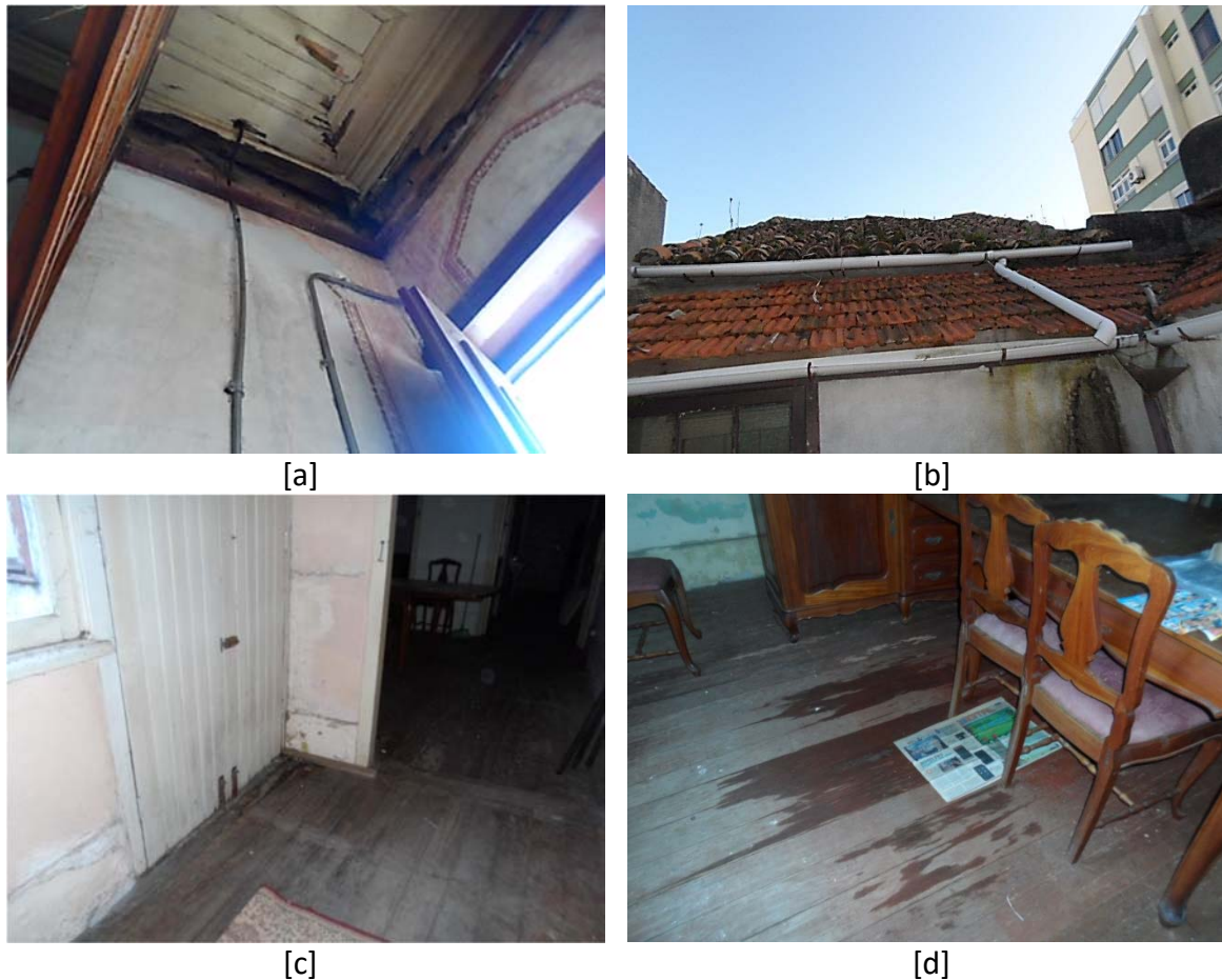
FIGURA 18: Infiltração descendente causada por deficiências no telhado, calhas e condutores: (a) forro de madeira com avançado processo de degradação pela umidade; (b) imagem do telhado da residência com problemas; (c) ação da água nas paredes, por ausência de telhado; (d) piso com água em função de falta de telhado.
