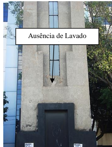
FIGURA 7: Ausência de lavado sujo localizado na VISTA LESTE.
