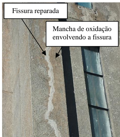
FIGURA 8: Exemplo de fissura longitudinal reparada localizada na VISTA NORTE.
