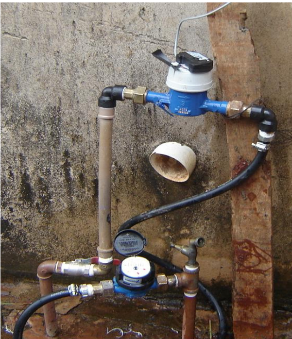
Figura 1: Conjunto de medidores instalados em série, composto por um medidor velocimétrico e por um volumétrico com registrador de volume.
