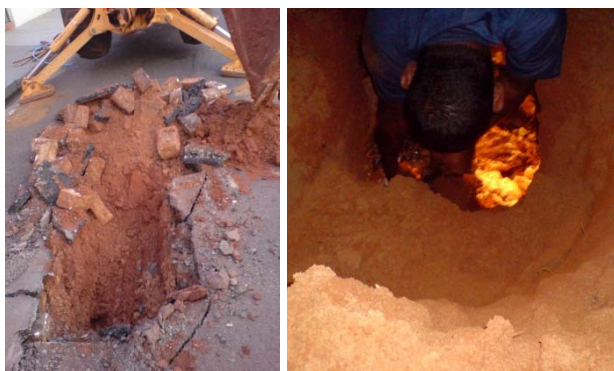
Figura 2: Localizações de um VNV com a formação de uma erosão sob o pavimento com a infiltração de água na rede coletora de esgotos.
