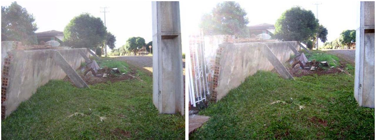
Figura 6: Área de calçamento inadequada e obstruída por suporte do muro atrapalhando a passagem de pedestres.
