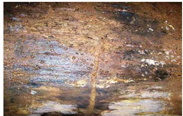
Figura 6: Ataque por insetos nas toras (vigas) de sustentação da Ponte C.
