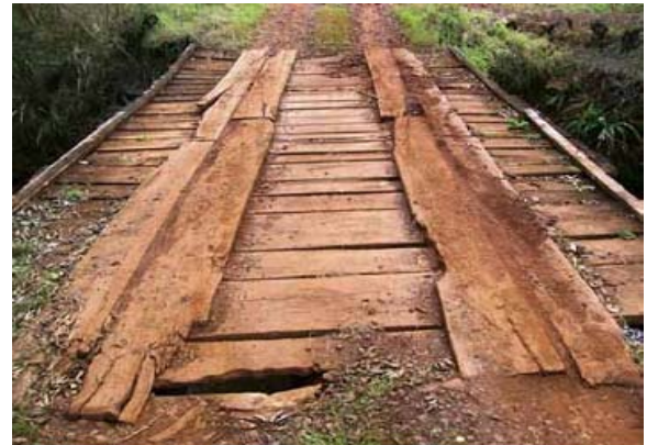
Figura 5: Vista do tabuleiro com indicação de diversos danos na Ponte B.
