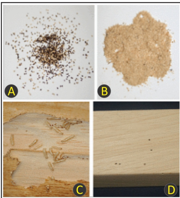
(A) - resíduo de madeira granulada gerado pelo ataque de cupins; (B) - resíduo de madeira em pó fino produzido por brocas; (C) - galeria de cupins; (D) - madeira atacada por brocas.
