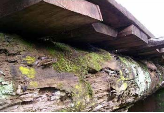
Figura 7: Viga da Ponte D em estágio de apodrecimento.
