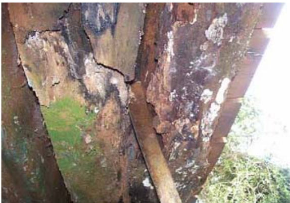
Figura 8: Viga de madeira em estágio avançado de decomposição na Ponte D.
