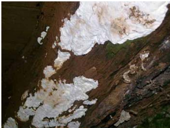
Figura 4: Ataque na madeira por bactérias e fungos na Ponte A.
