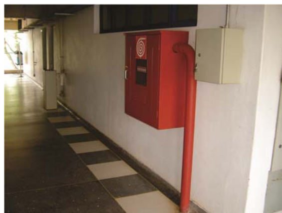
Figura 47: Hidrante falta de sinalização de piso delimitando uma área de 1m 2 livre à frente do abrigo.
