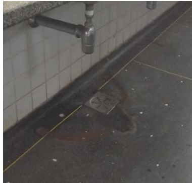
Figura 26: Acúmulo de água, futuro ponto de infiltração próximo à caixa sifonada.
