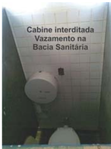
Figura 35: Cabine interditada devido ao vazamento na vedação da bacia sanitária.
