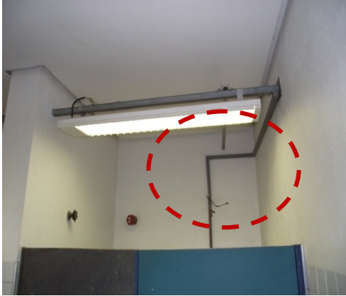
Figura 12: Chuveiro desativado no banheiro feminino.
