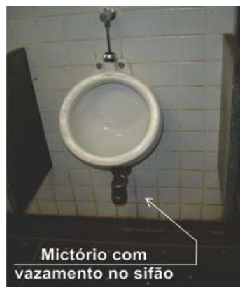
Figura 22: Vazamento no sifão do mictório.
