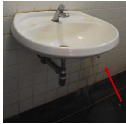
Figura 40: Torneira de limpeza apresentando vazamento.
