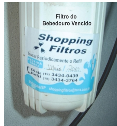
Figura 43: Falta de manutenção do elemento filtrante dos bebedouros.
