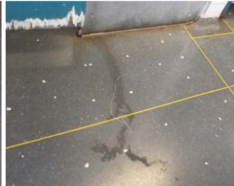
Figura 27: Provável escoamento contínuo proveniente do tanque.
