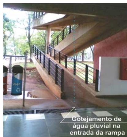
Figura 19: Gotejamento de água pluvial na entrada da rampa.
