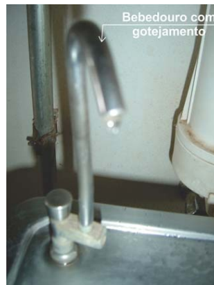
Figura 42: Gotejamento contínuo de um dos bebedouros do pavimento.
