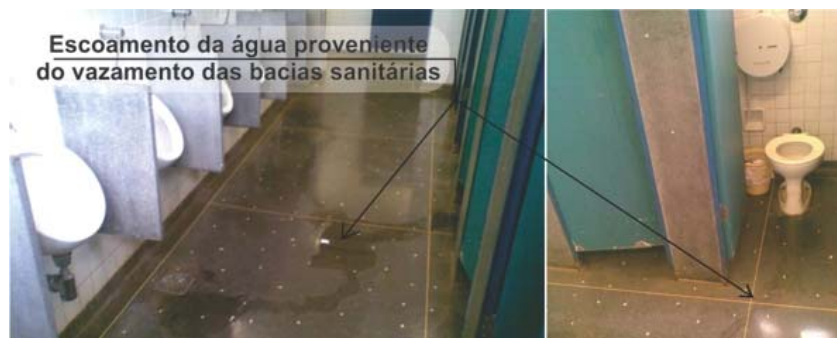
Figura 21: Vazamento na vedação de três bacias sanitárias com escoamento contínuo.
