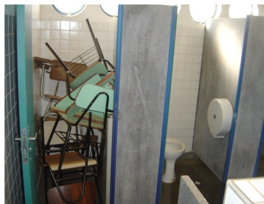
Figura 38: Espaço originalmente destinado ao tanque – retorno de mau cheiro pelo tubo de esgoto devido a perda do selo hídrico.
