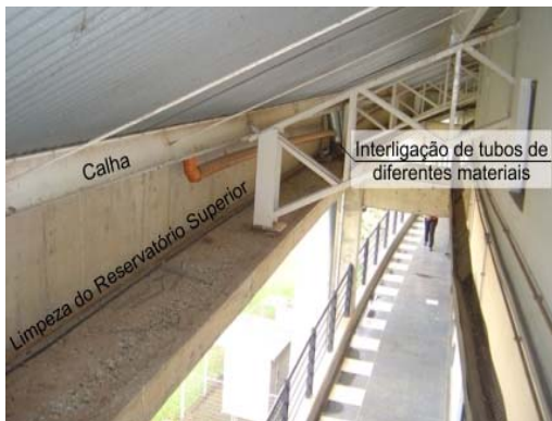
Figura 50: Condutor de água pluvial com interligação de três tubos de materiais e diâmetros diferentes.
