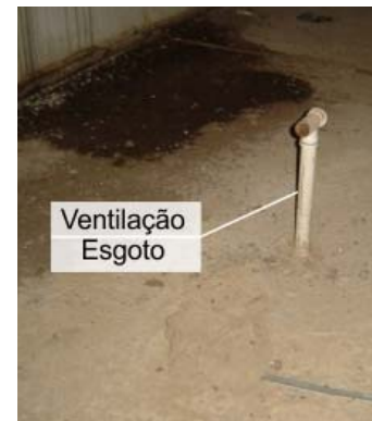
Figura 52: terminal de ventilação sobre a laje de cobertura.
