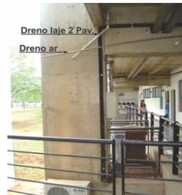
Figura 29: Adaptação precária do dreno do ar condicionado e dreno da laje do pavimento superior.
