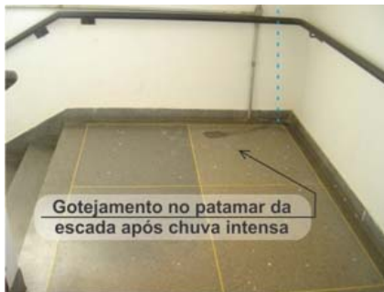
Figura 31: Gotejamento no patamar da escada após chuva intensa.
