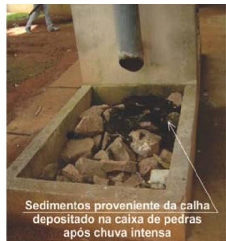
Figura 15: Sedimento proveniente da calha depositado na caixa de pedras após chuva intensa.
