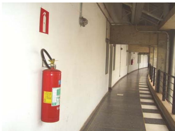
Figura 46: Falta de identificação de tipo de extintor na sinalização e marcação de piso.
