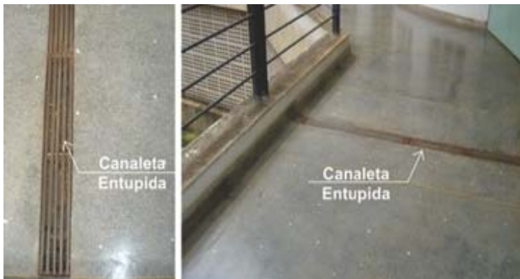
Figura 28: Falta de manutenção da grelha da passarela de interligação com edifício anexo, proporcionando acúmulo de água durante e após a ocorrência de chuvas.
