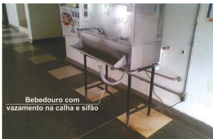
Figura 18: Bebedouro do pavimento térreo com pontos de vazamento na calha e no sifão.
