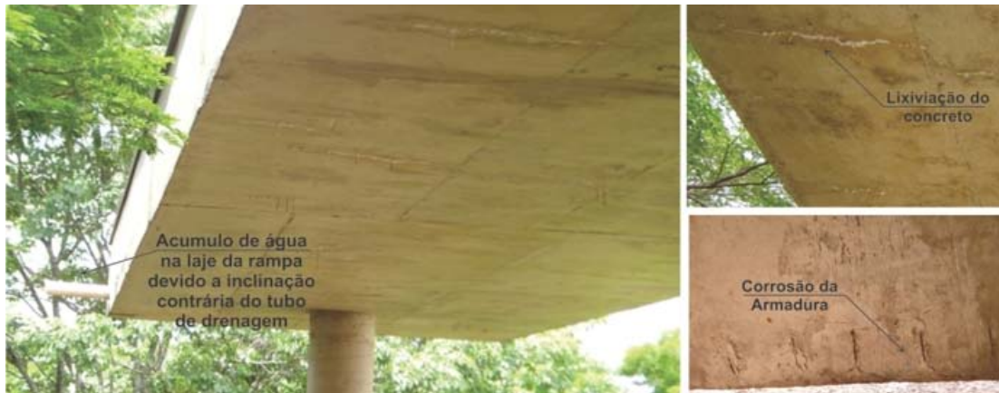
Figura 30: Dreno da laje de cobertura da rampa com declividade invertida proporcionando acumulo de água que contribui para o processo de lixiviação da laje e corrosão da armadura.
