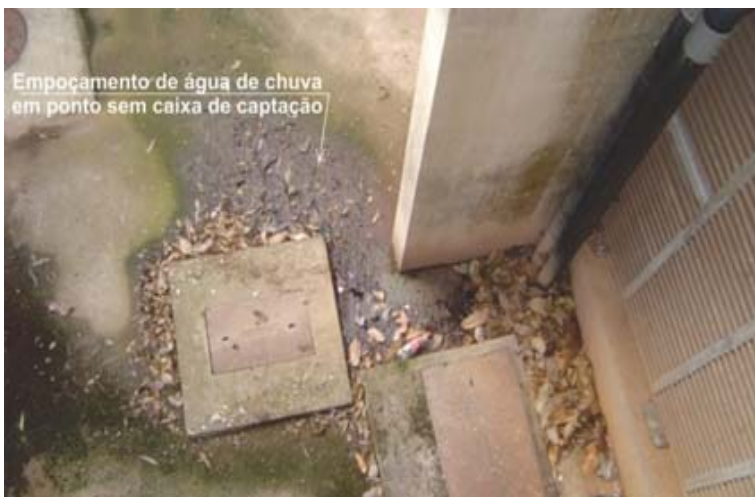
Figura 14: Ponto de empoçamento de água pluvial no pavimento térreo com acúmulo de sedimentos devido a inexistência de caixa de captação de água pluvial.
