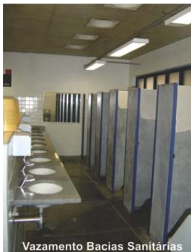
Figura 34: Escoamento de água no piso devido ao vazamento na vedação da bacia sanitária.
