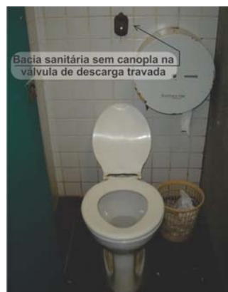
Figura 23: Botão de acionamento da bacia sanitária sem canopla.
