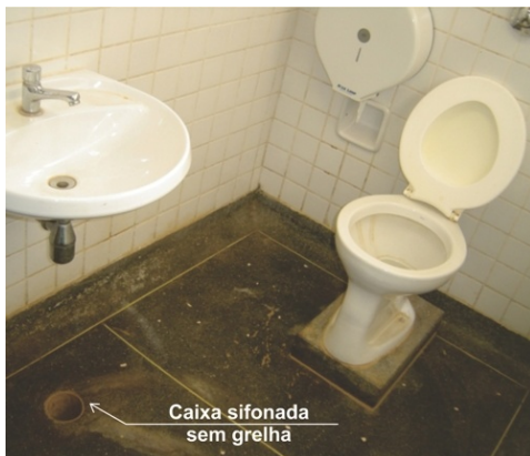
Figura 41: Caixa sifonada sem grelha.
