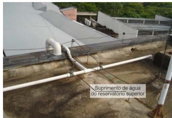
Figura 54: Tubulação de abastecimento do reservatório superior exposta à intempéries.
