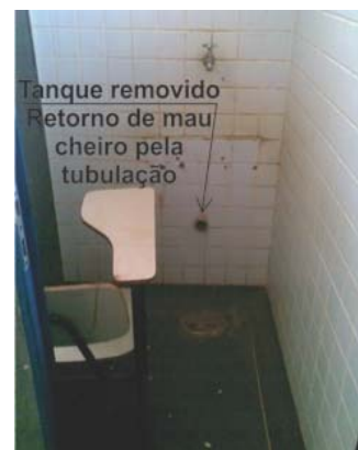
Figura 24: Retorno de mau cheiro pela tubulação de esgoto do tanque.
