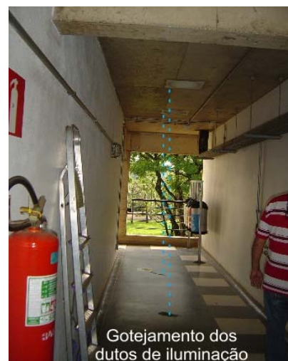
Figura 44: Gotejamento no corredor proveniente dos dutos de iluminação da edificação.
