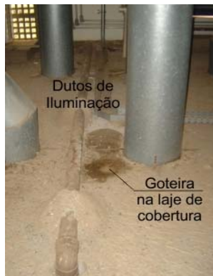
Figura 51: Gotejamento na laje do barrilete.
