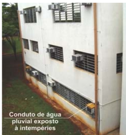
Figura 16: Tubulação de água pluvial exposta à intempéries.
