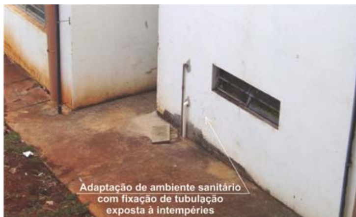
Figura 17: Adaptação de ambiente sanitário com tubulação exposta à intempéries.
