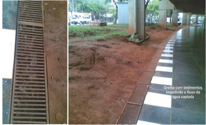
Figura 13: Grelha no pavimento térreo com deposição de sedimentos impedindo o fluxo adequado de água.
