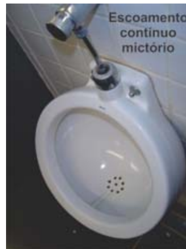
Figura 36: Mictório com vazamento e escoamento contínuo de água.
