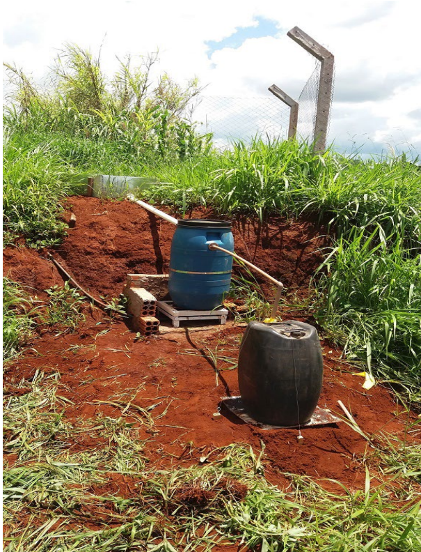
Figura 2 - Sistema coletor de água por escoamento superficial.
