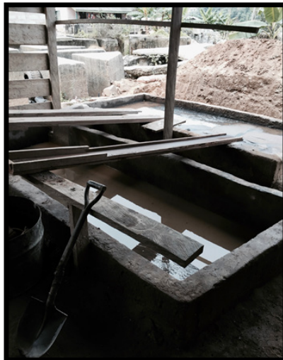
Imagem 4 - Tanques de decantação em Tarkwa (Western Region). Gana, 2016.
