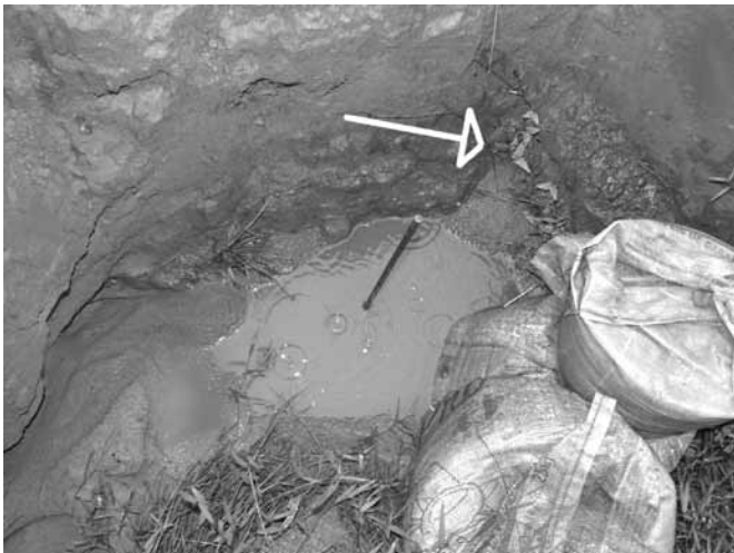
Figura 5 - Acúmulo da água devido à colocação da barreira e aparecimento de vegetação.
