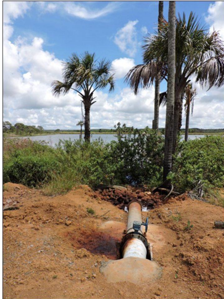
Figura 7: Tubulação de descarga de fundo com registro hídrico utilizado para controle de vazão no Alto São Marcos
