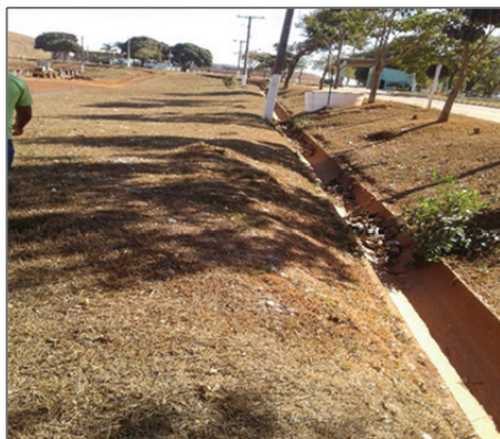
Figura 7. Dreno de águas pluviais. Fonte: Autor, 2016.
