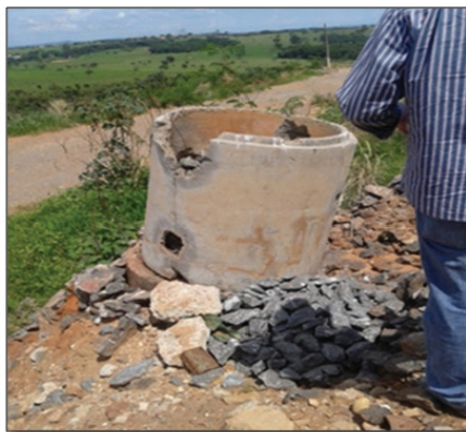
Figura 8. Tubulações para queima de gases. Fonte: Autor, 2015.
