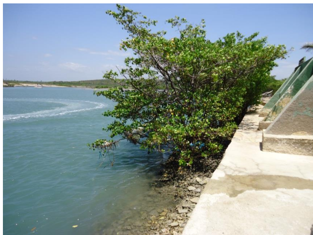
Figura 8: Estrangulamento antrópico da foz do Rio Mal Cozinhado, município de Cascavel (CE). Fonte: Autores (2014). Coordenada UTM / Datum SIRGAS 2000 / E=590.438; N=9.551.432.
