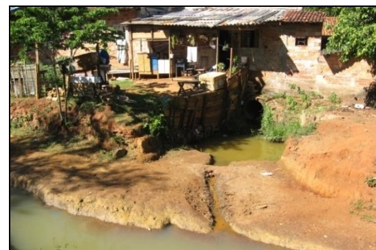
4 – Foto de erosão na base de uma residência, no Jardim Guanabara II.
